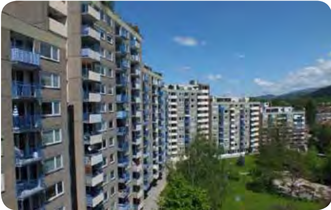
Die Waschbetonfassade vor der Sanierung.
