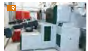
Kesselanlage (Bild: Energiegenossenschaft Kappel eG)
