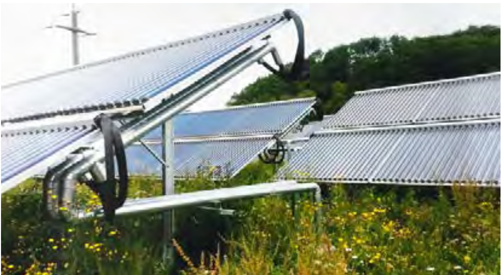
Solarthermieanlage (Bild: Verbandsgemeindewerke Simmern)
